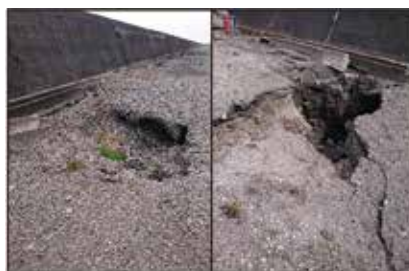
陥没発生状況
